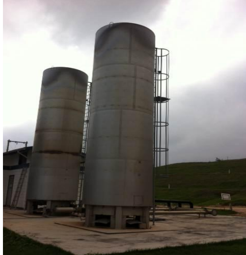
Figura 94: Unidade de tratamento do biogás.
