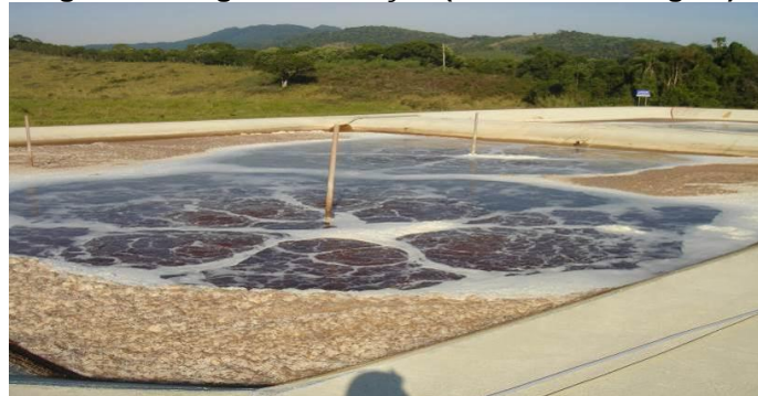
Figura 91: Lagoa de Aeração (Processo Biológico).
