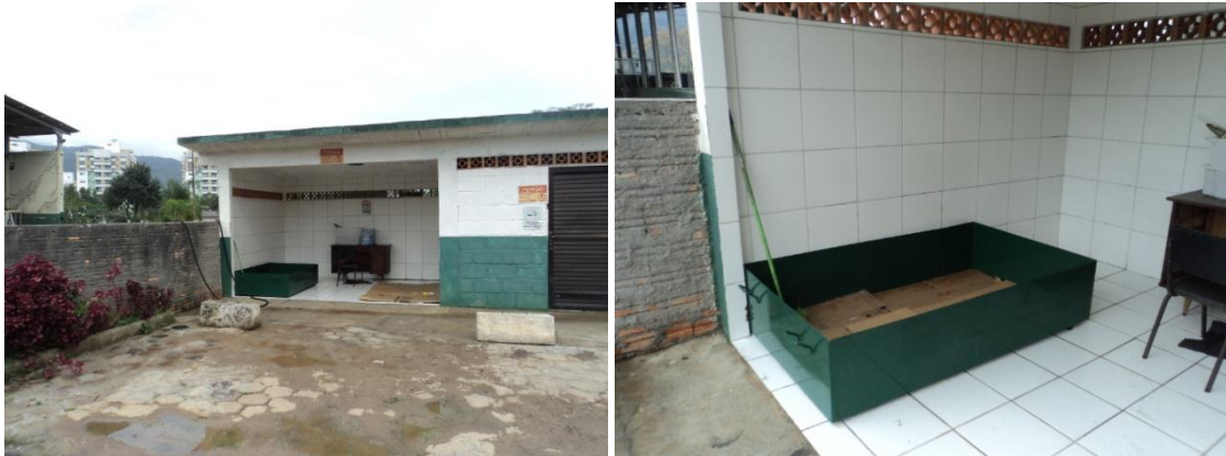
Figura 63: Bacia de contenção do Depósito Temporário de Produtos Químicos
