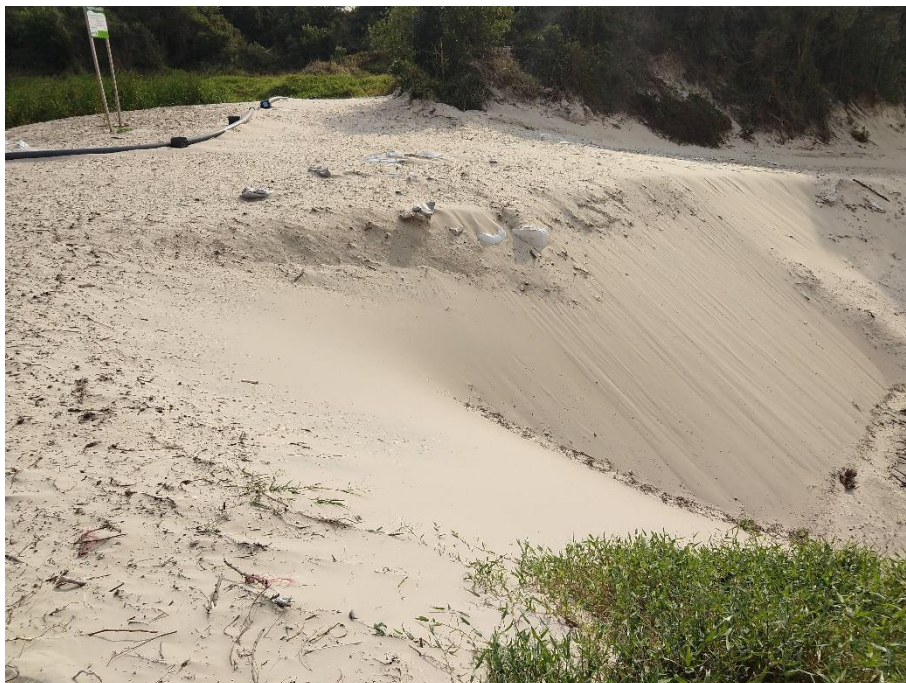
Figura 6. Condições da ensacadeira, vista em perfil com visada a oeste (Foto: 18/08/2021)
