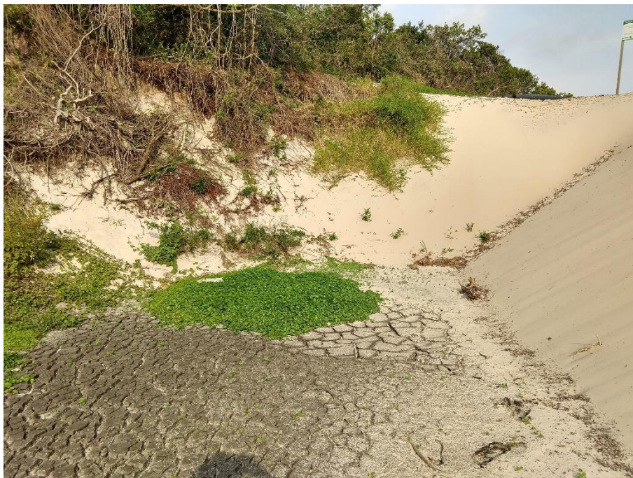
Figura 8. Área a jusante da ensacadeira, situada entre a rampa de acesso e o talude natural a leste (Foto: 18/08/2021).
