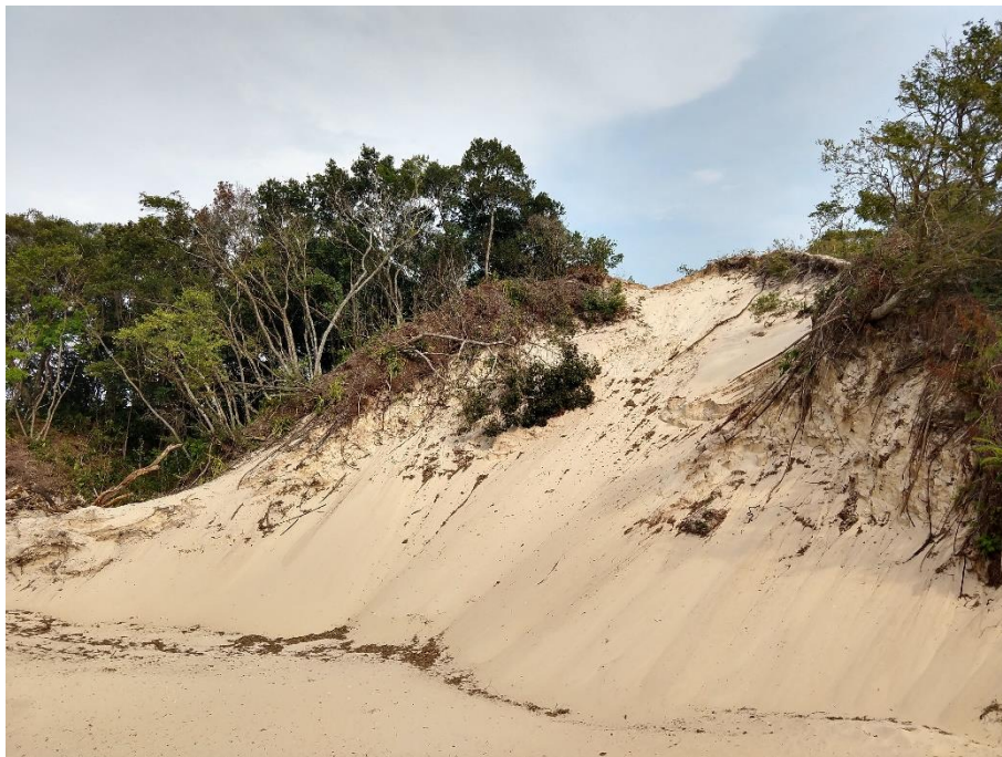
Figura 2. Situação do talude adjacente ao acesso – lateral sul (Foto: 18/08/2021)
