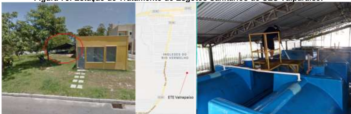
Figura 78: Estação de Tratamento de Esgotos Sanitários do SES Valparaíso.
