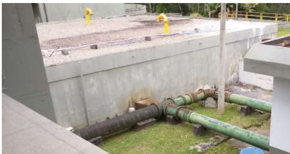
Figura 34: Reservatório de Contato
