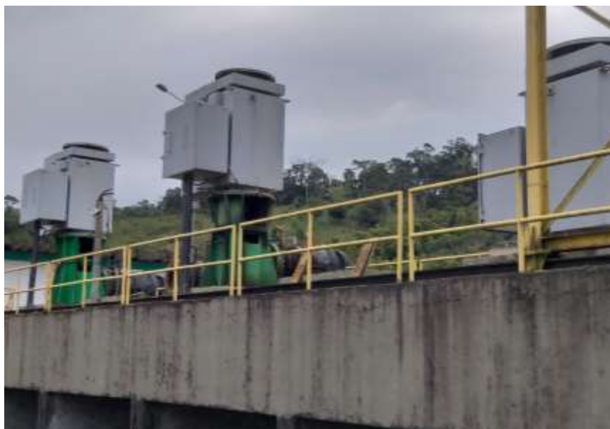
Figura 25: Conjunto motobombas - captação Rio Cubatão do Sul
