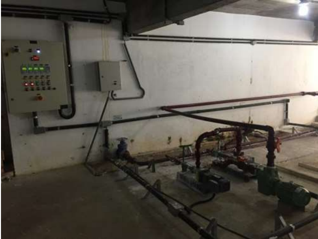
Figura 27: Dosadores de hidróxido de cálcio
