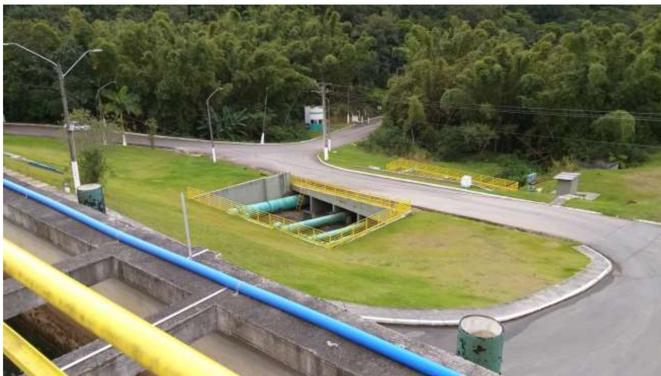
Figura 40: Adutoras de água tratada
