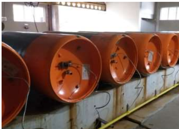
Figura 35: Armazenamento de cloro gás
