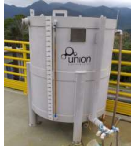
Figura 28: Dosadores de sulfato de alumínio
